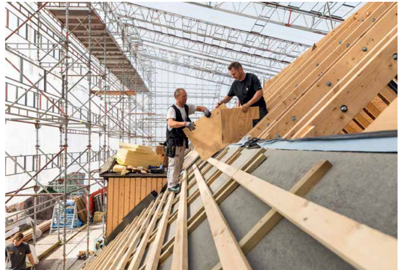
Anders og Karsten lægger tag for Byens Tag og Facader og er medlemmer i PensionDanmark
