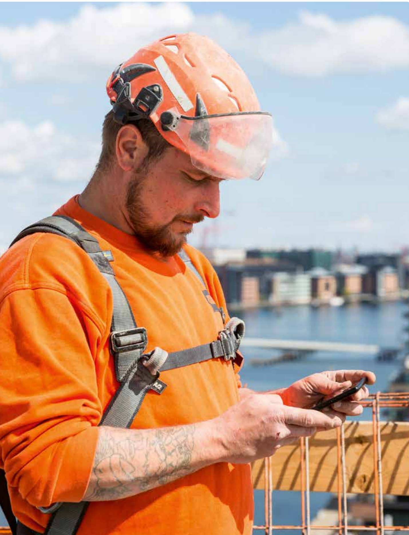
Brian arbejder på PensionDanmarks byggeri Sirius på Islands Brygge og er medlem af PensionDanmark
